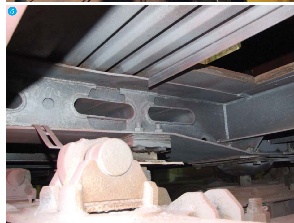
Рис. 1. Шкворневая балка с усиливающими косынками: а) до усиления; б) после усиления
