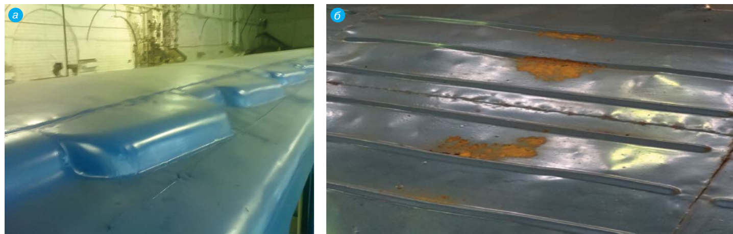
Рис. 3. Крыша вагона Нижегородского метрополитена: а) ржавая гофрированная крыша; б) – гладкая крыша после ремонта
