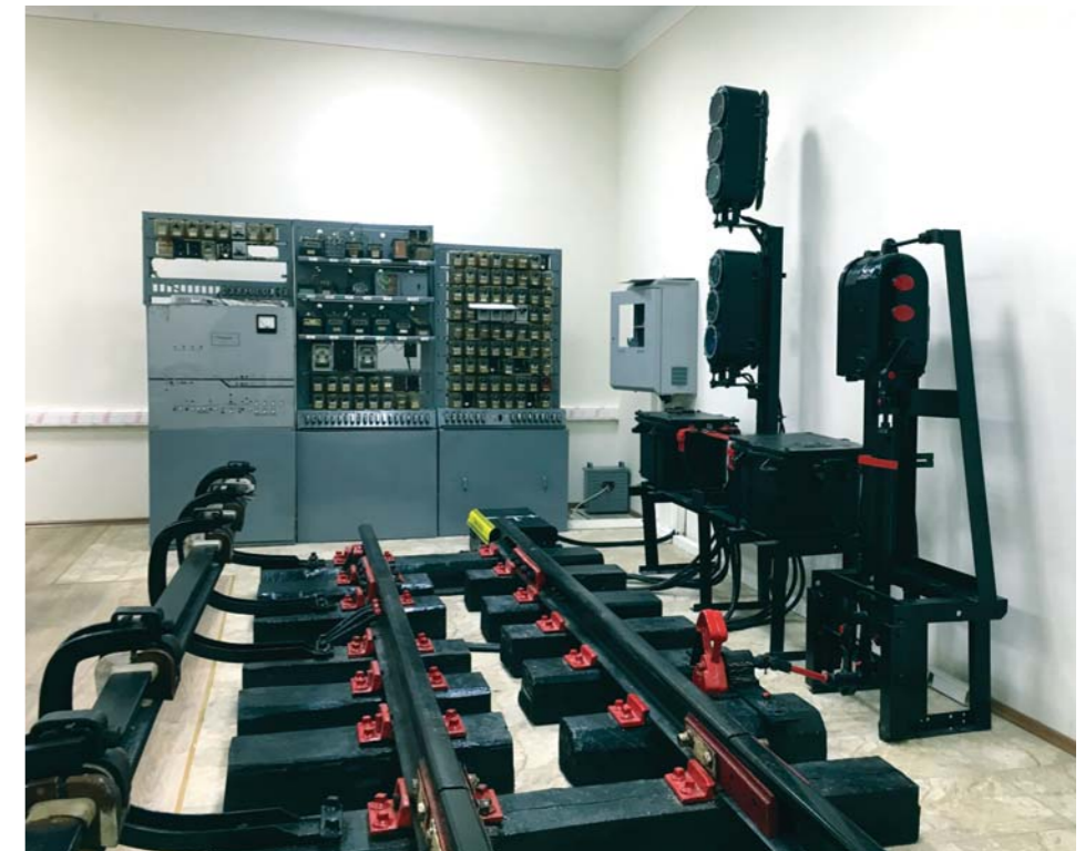
Оснащение технического кабинета в Бакинском метрополитене
