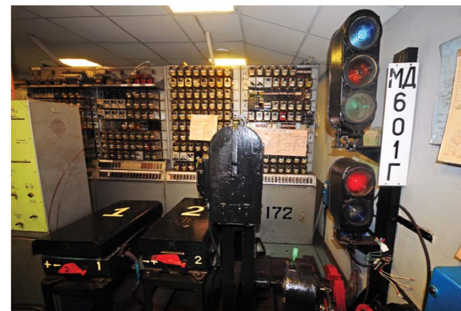
Учебные устройства в одном из технических кабинетов в Московском метрополитене
