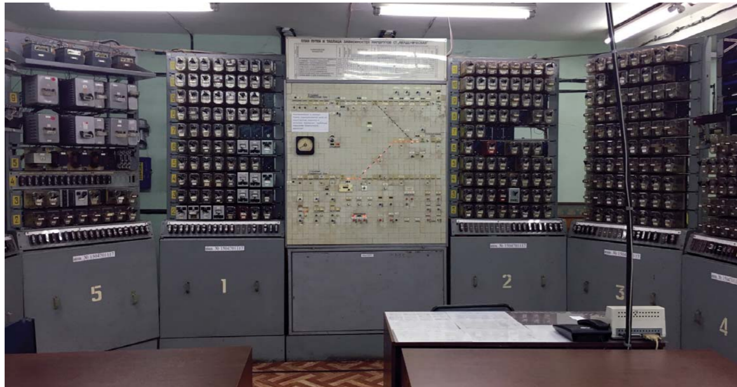
Оснащение технического кабинета в метрополитене Санкт-Петербурга
