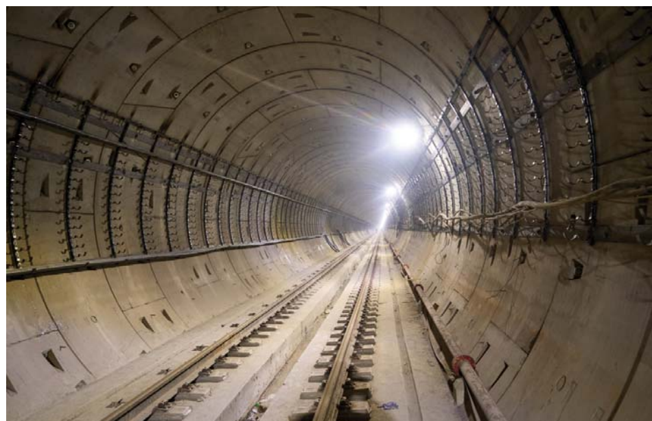
Фото 2. Система освещения туннеля от ООО «Эвентуаль»
