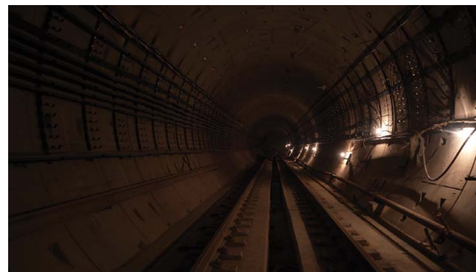
Фото 1. Система освещения туннеля лампами накаливания
