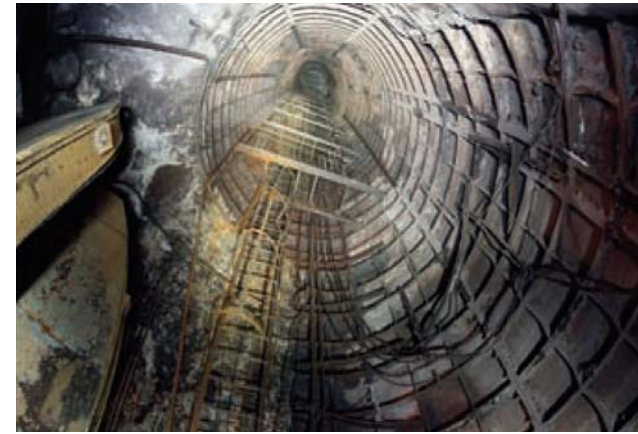
Рис. 9. Верхний вентиляционный узел вентиляционной шахты
