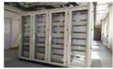
Шкафы с аппаратурой релейных объектов контроллеров
